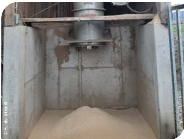
Abb. 131: Strohmatic Air – Entstaubung
